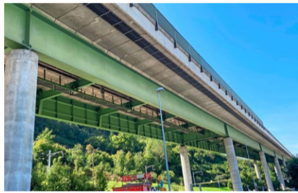
A12 bei Flamatt: Ein sichtbarer Einsatz von Stahl im Viadukt mit Stahlträgern.
