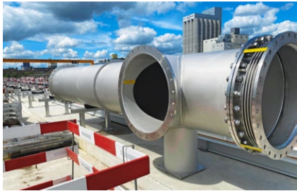
Wasseraufbereitung: Diese kommt nicht ohne Bauteile aus rostfreiem Stahl aus.
